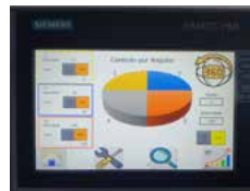
Control de Rega por ângulos
